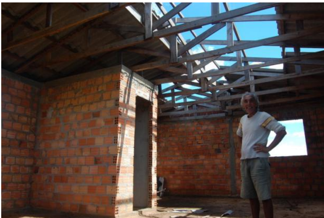
Figura 21 – Obras paradas de uma residência no PA Conquista do Cerro da Liberdade
