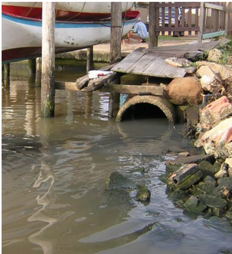
Figura 3.29: Ponto #2. Cano de concreto que drena água pluvial e esgoto doméstico provenientes do canal a céu aberto que percorre o canteiro central da Avenida Santa Rosa, no município de Imbé.
