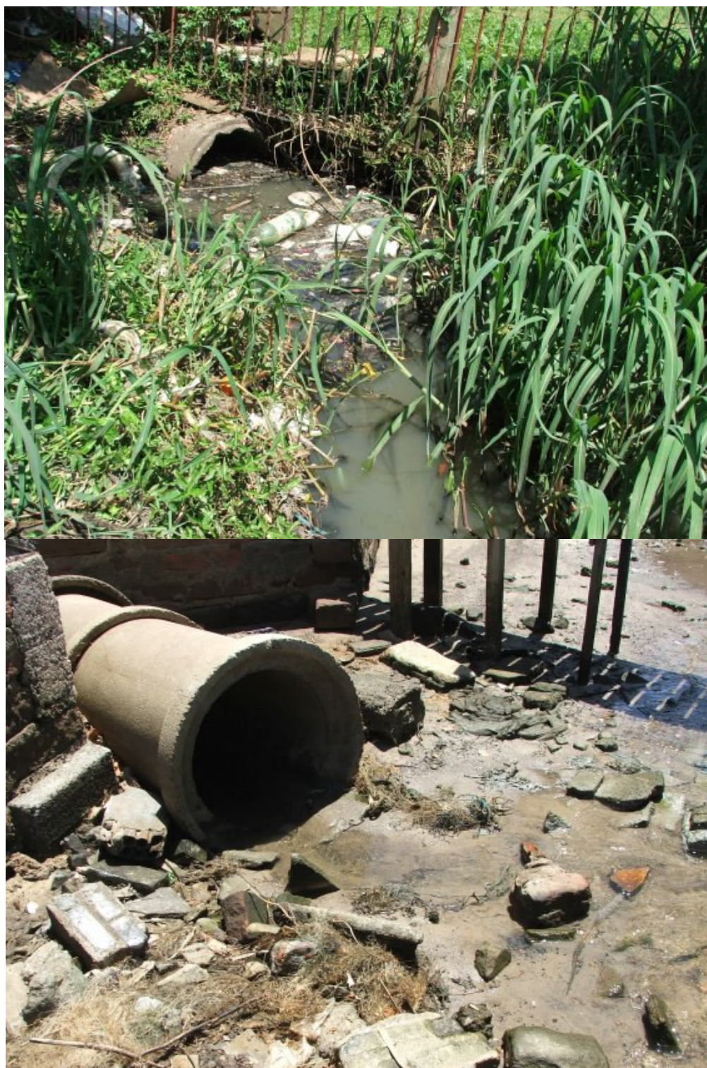
Figura 3.30: Foto superior: ponto #3, situado no final da Rua Sapiranga, no município de Imbé e classificado como muito contaminado. Foto inferior: ponto #27, situado no final da Rua Francisco Caetano de Azevedo, no município de Tramandaí.
