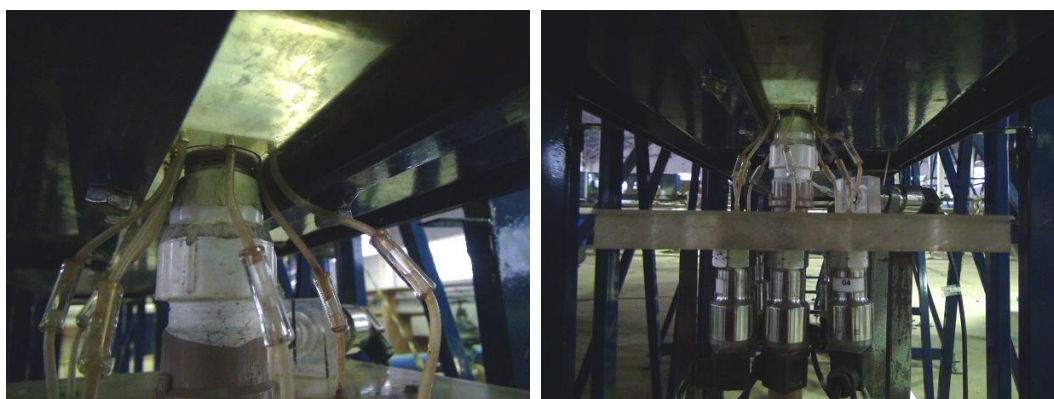
Figura 4.11 – ligação das tomadas aos transdutores de pressão
