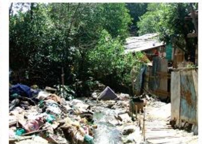
Situação da planície de inundação, próximo a rua "B" alterada e totalmente assoreada com lixo e entulho depositado na calha do arroio da Vila Pinto. No lado direito moradias em risco de inundação. Extraído de PMPA (2011a).
