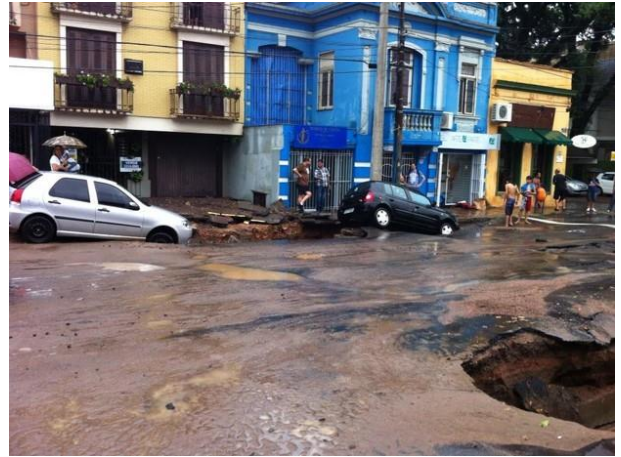
Figura 07: Automóveis caíram na abertura causada pelo rompimento da estrutura de escoamento da água pluvial em fevereiro de 2013 na Rua Cel Bordini em Porto Alegre/RS. Foto de Barbara Mattivy. Fonte: g1.com.br
