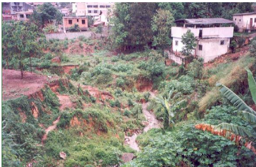
Figura 21: Trecho do córrego 1º de Maio em processo de degradação ambiental (2003). Fonte: BARBOSA, 2011.
