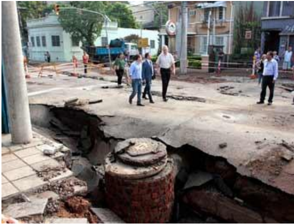
Figura 06: Estrutura de escoamento da água pluvial cedeu em fevereiro de 2013, na Rua Cel Bordini em Porto Alegre/RS. Foto de Ricardo Giusti. Fonte: g1.com.br
