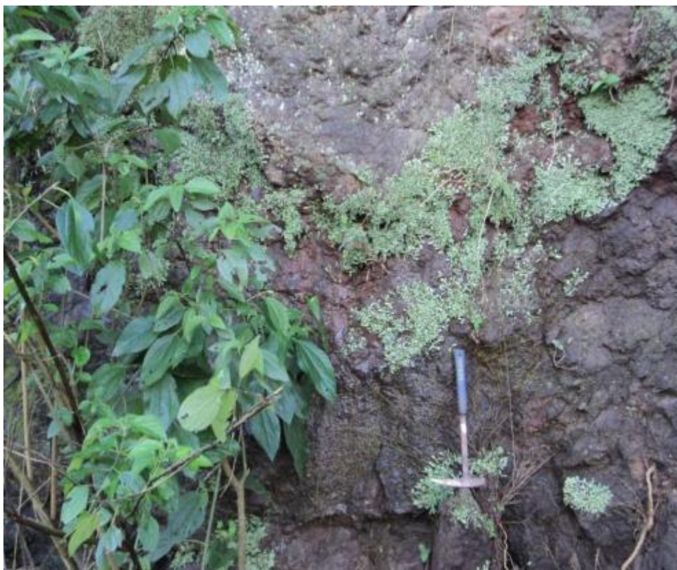
Figura 32 – Circulação de água fraturas
