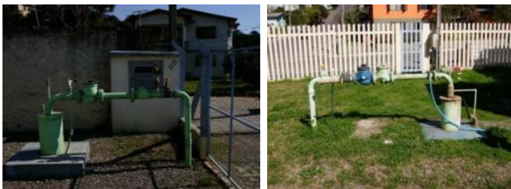
Figura 17 - Poços existentes da Corsan COR CBA 03 A (esq.) e COR CBA 04 (dir.) detalhes do selo sanitário e perímetro de proteção
