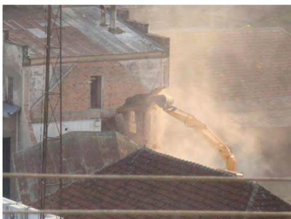
Demolição ilegal realizada no dia 07 de setembro de 2012. Fonte: Internet
