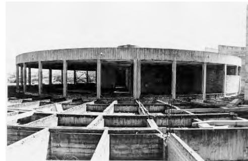
foto obra embargada
