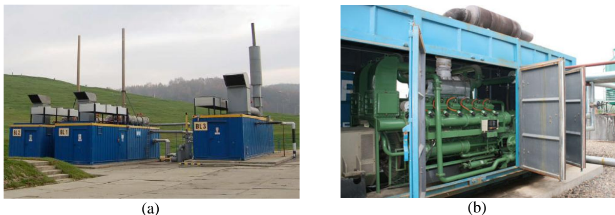
Figura 4.5 –Motogeradores para uso de biogás em aterros sanitários: (a) aterro sanitário de Barycz, Cracóvia – Polônia; (b) Aterro sanitário de Luohe – China [INiG, 2010; UPM, 2013]
