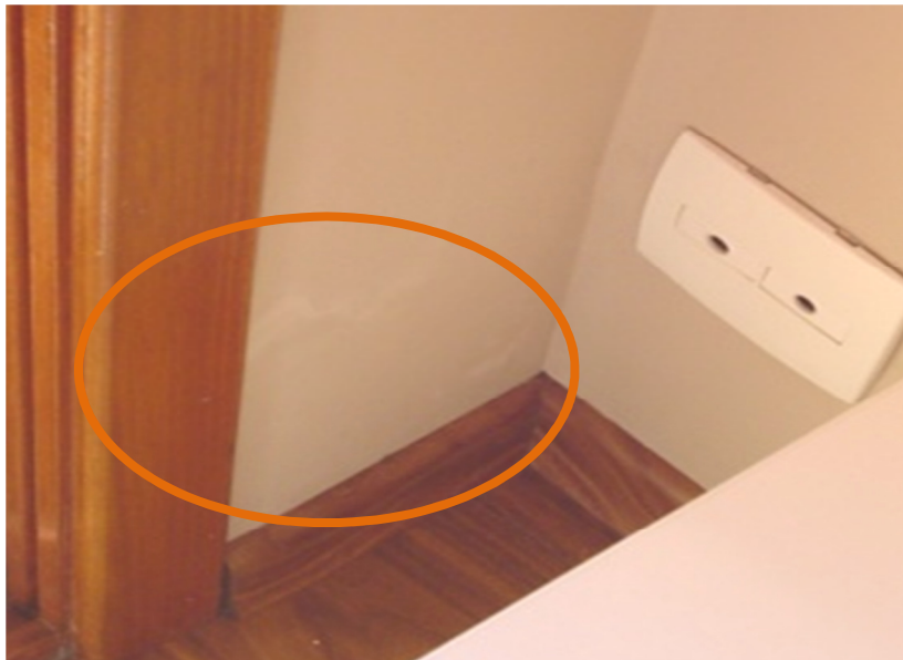
Figura 39 – Manchamento por presença de umidade
