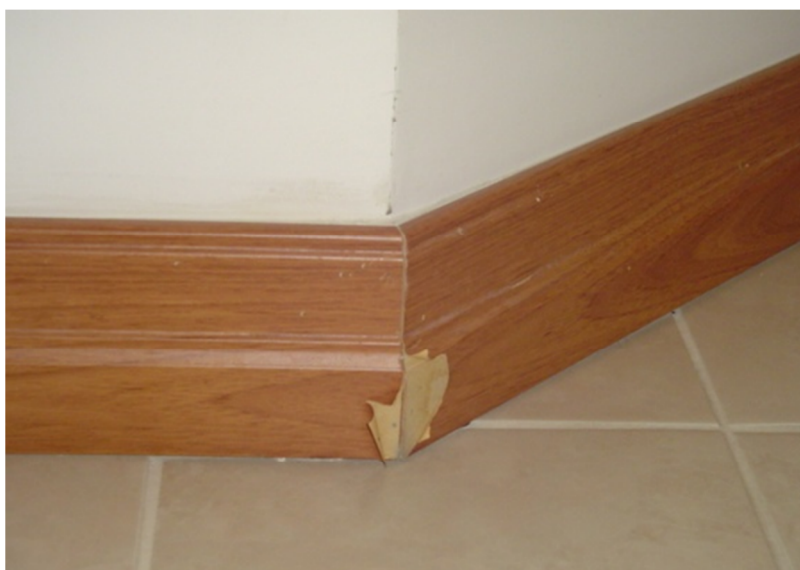
Figura 60 – Rodapé com falha em acabamento
