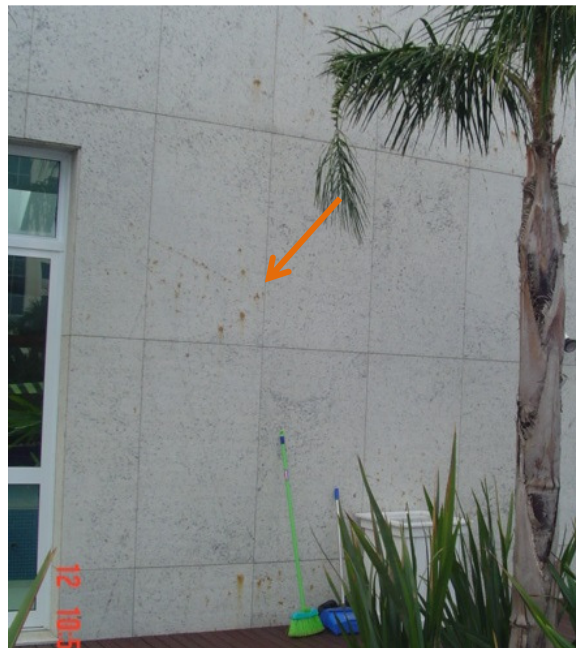
Figura 53 – Manchamento em revestimento de granito por alteração nos minerais constituintes
