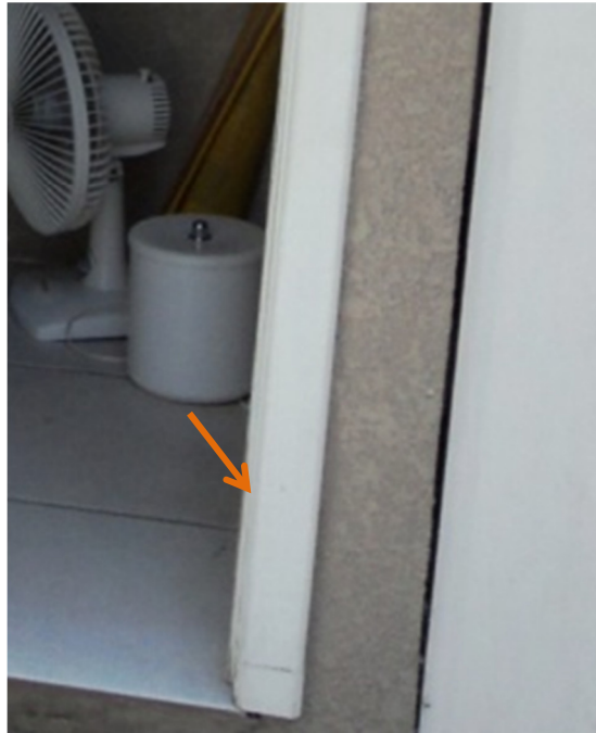
Figura 25 – Manchamento de guarnição por excesso de umidade
