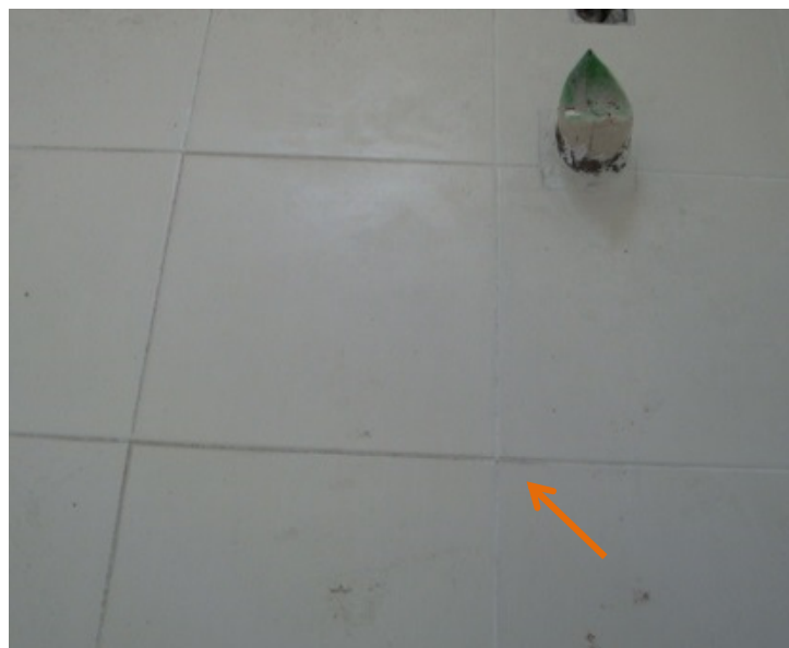
Figura 63 – Piso cerâmico com pontas levantadas
