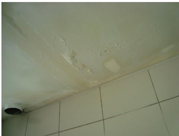
Figura 89 – Forro de cozinha danificado por presença de umidade decorrente de vazamento
