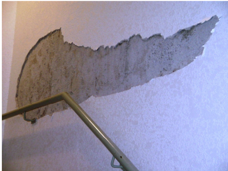
Figura 41 – Descolamento de revestimento sobre concreto em parede de escadaria
