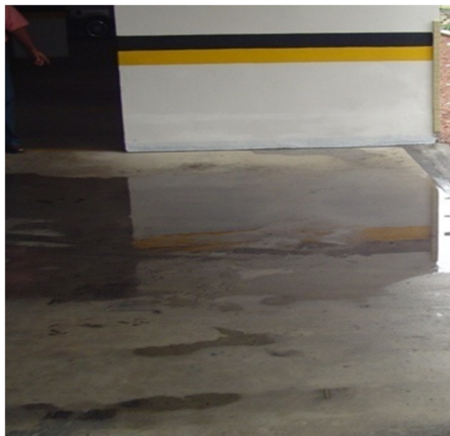
Figura 68 – Empoçamento de água em piso de estacionamento por falta de desnível
