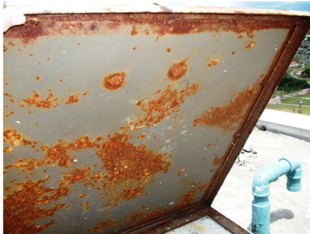
Figura 32 – Defeito em esquadria de aço por oxidação
