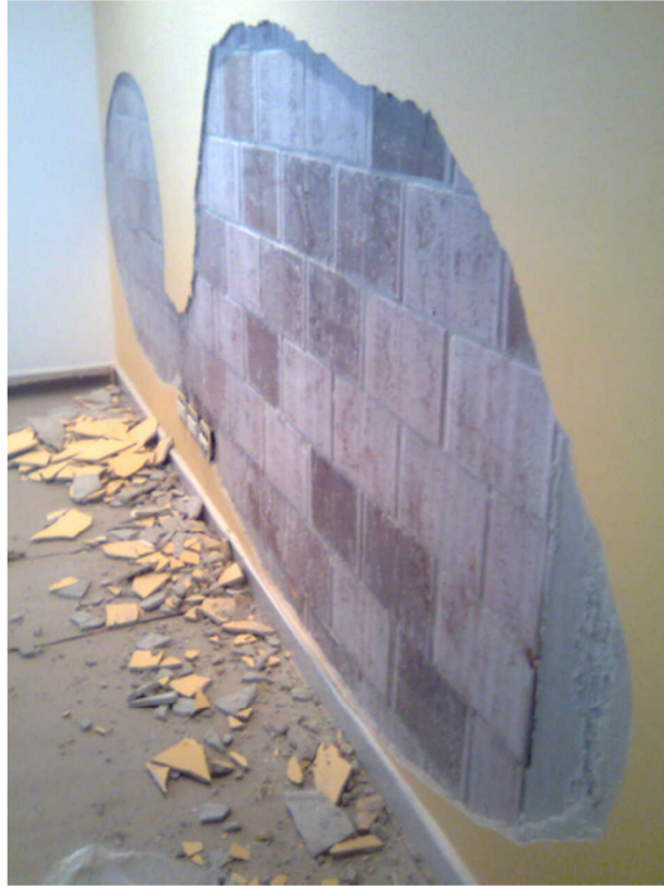
Figura 40 – Descolamento de revestimento sobre alvenaria em parede interna
