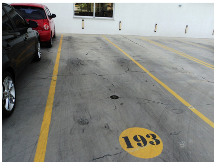
Figura 69 – Fissuras em piso de concreto
