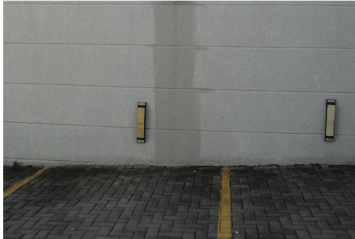
Figura 46 – Umidade em revestimento externo
