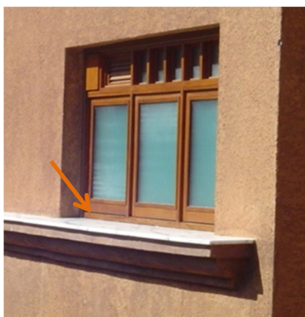
Figura 28 – Infiltração em janela por falta de inclinação do peitoril
