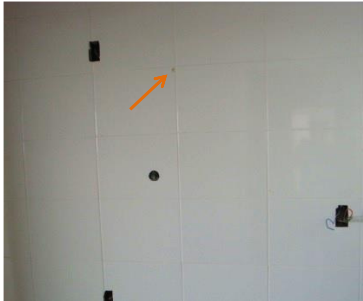
Figura 56 – Cerâmica com canto lascado decorrente de falha de execução
