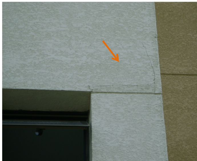
Figura 45 – Fissura em revestimento de fachada
