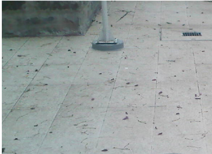
Figura 72 – Manchamento de piso
