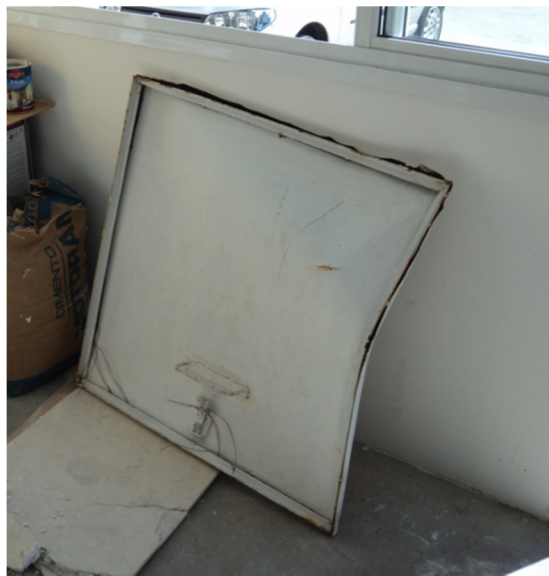
Figura 33 – Esquadria de aço solta caiu da cobertura até o pavimento térreo
