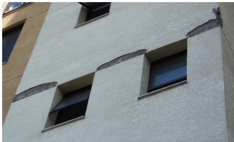
Figura 47 – Descolamento e deslocamento de revestimento de fachada
