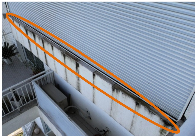
Figura 52– Sujidade na fachada decorrente da execução inadequada do elemento de descolamento da água da chuva
