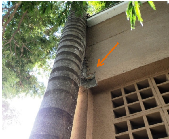
Figura 51 – Pendência deixada na execução do revestimento com parte do substrato sem argamassa
