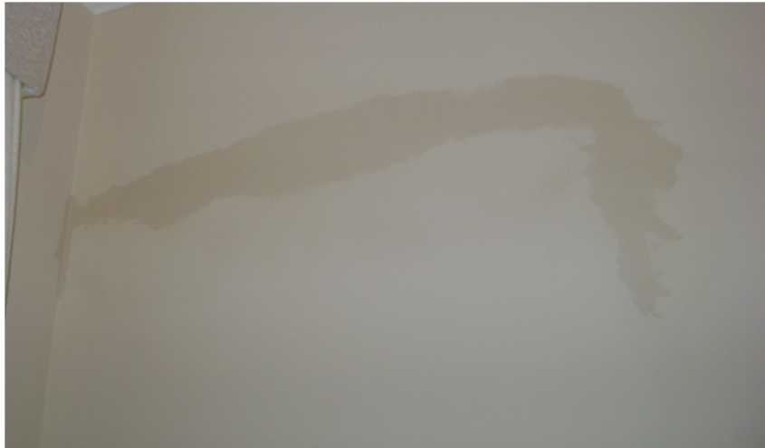
Figura 38 – Presença de água proveniente de infiltração no revestimento
