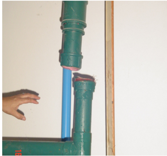
Figura 81 – Rompimento de conexão por falha em solda
