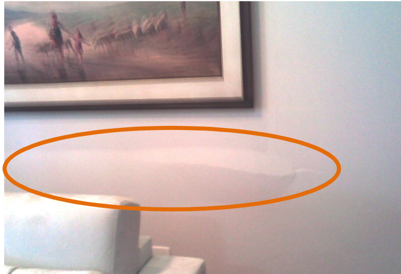
Figura 42 – Descolamento do revestimento interno no ambiente: sala de estar
