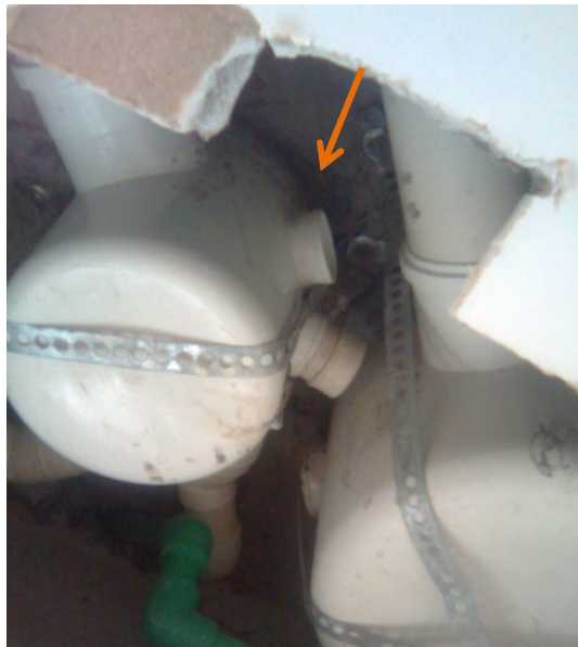
Figura 78 – Falta de conexão ou tamponamento
