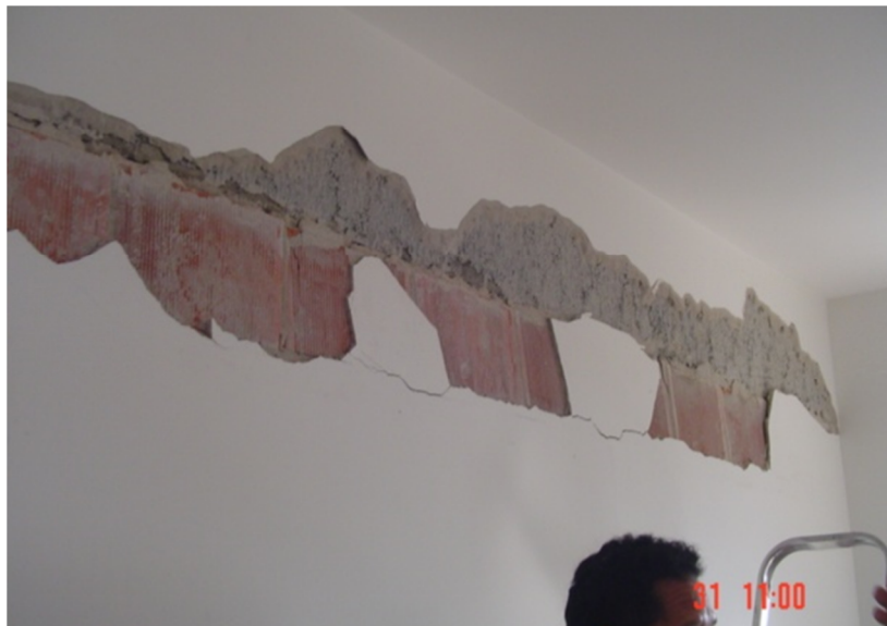
Figura 37 – Fissura com descolamento em zona de encunhamento
