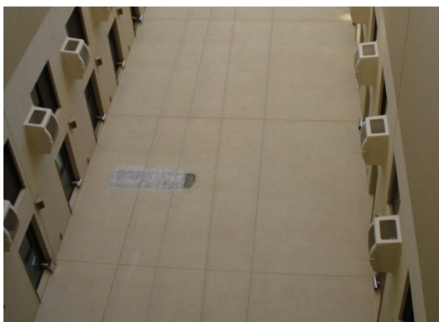
Figura 49 – Descolamento de revestimento de fachada
