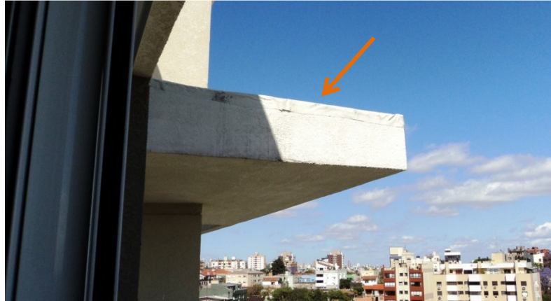
Figura 50 – Falta de acabamento no revestimento superior da platibanda da fachada
