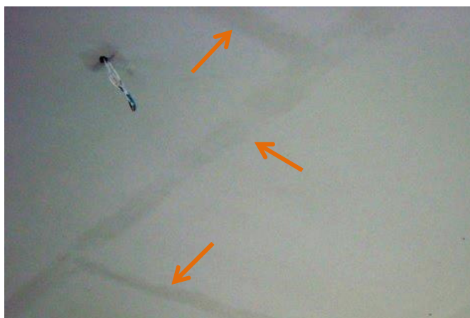
Figura 91 – Manchamento das juntas de encontro entre placas
