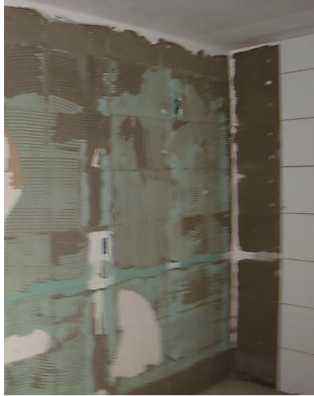
Figura 58 – Remoção completa das peças cerâmicas para posterior reparo de parede que apresentou descolamento das peças
