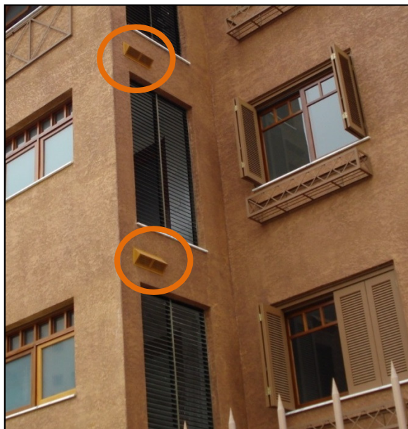
Figura 54 – Grelha de exaustão na fachada – ponto de entrada de água responsável pelo aparecimento de manchas de umidade internas
