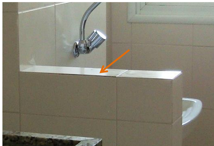
Figura 57 – Falta de preenchimento das juntas entre peças
