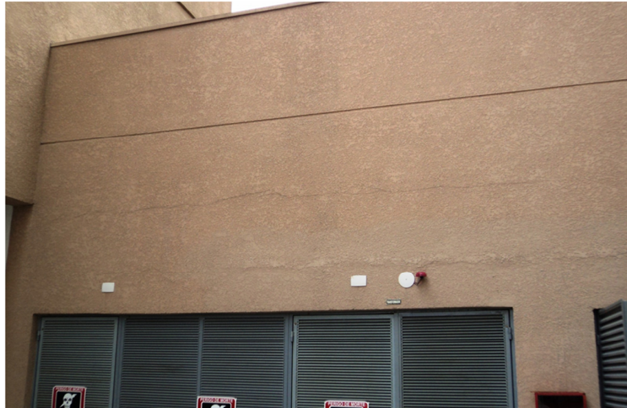
Figura 44 – Fissura em revestimento externo da subestação
