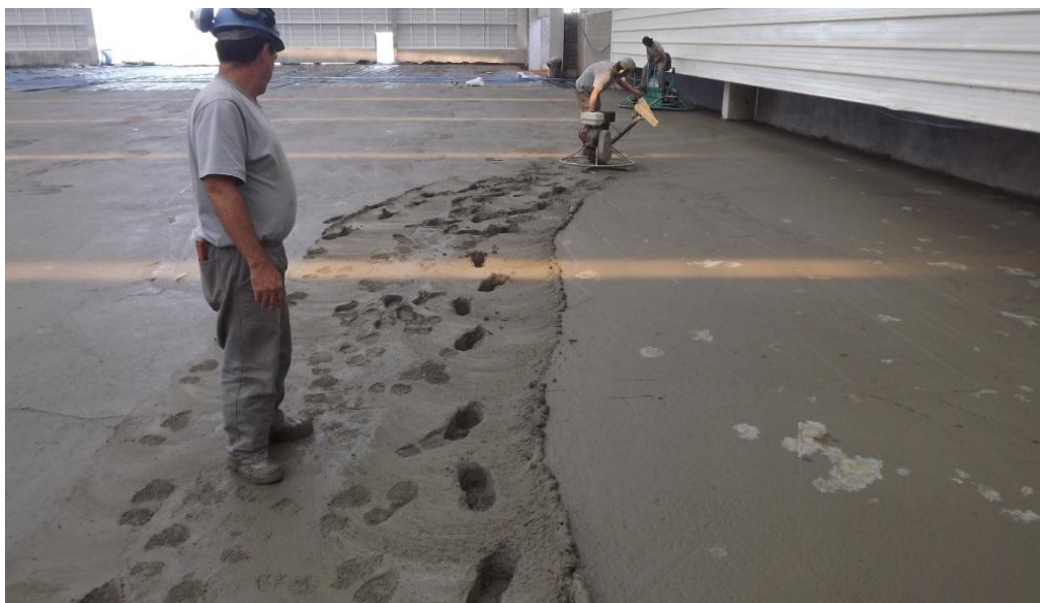
Figura 14 – Concreto com problema no aditivo na obra D
