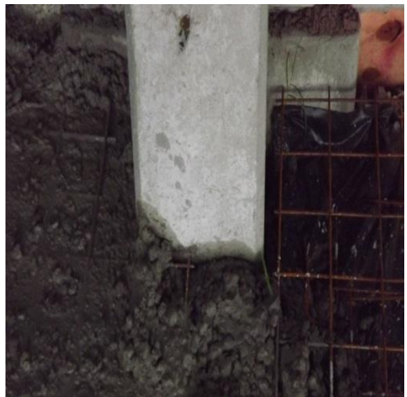
Figura 20 – Pilar sem junta de encontro na obra C
