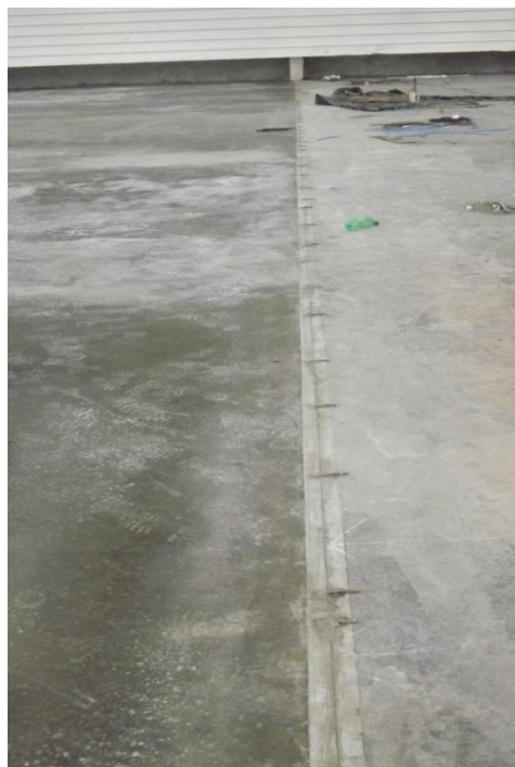
Figura 29 – Junta metálica na obra D
