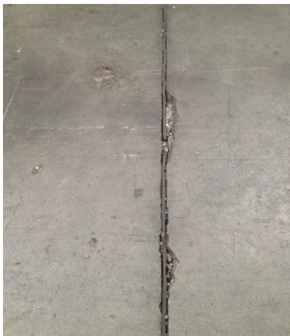
Figura 21 – Junta de construção esborcinada
