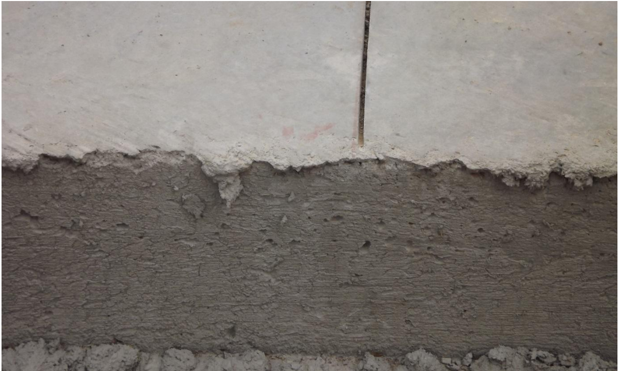
Figura 24 – Corte da junta serrada sem a profundidade correta na obra C
