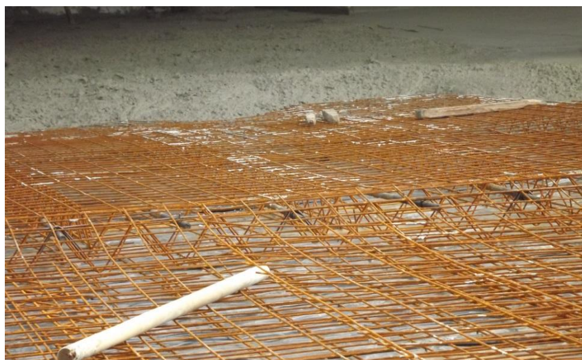
Figura 12 – Armadura irregular na Obra C
