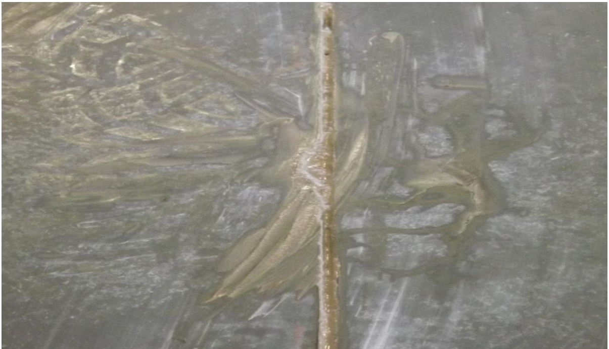
Figura 25 – Esborcinamento da junta serrada na obra A
