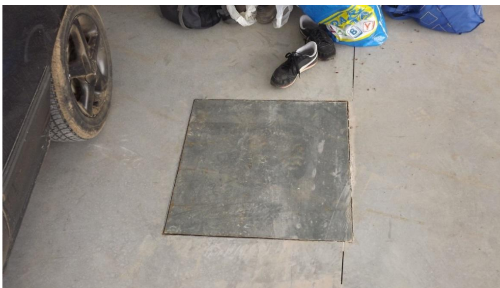
Figura 15 – Junta serrada interrompida por caixa de inspeção na Obra C
