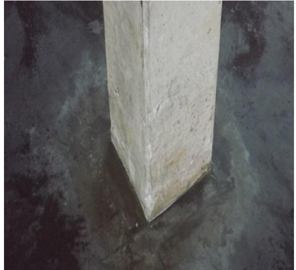
Figura 18 – Pilar sem junta de encontro na obra A
