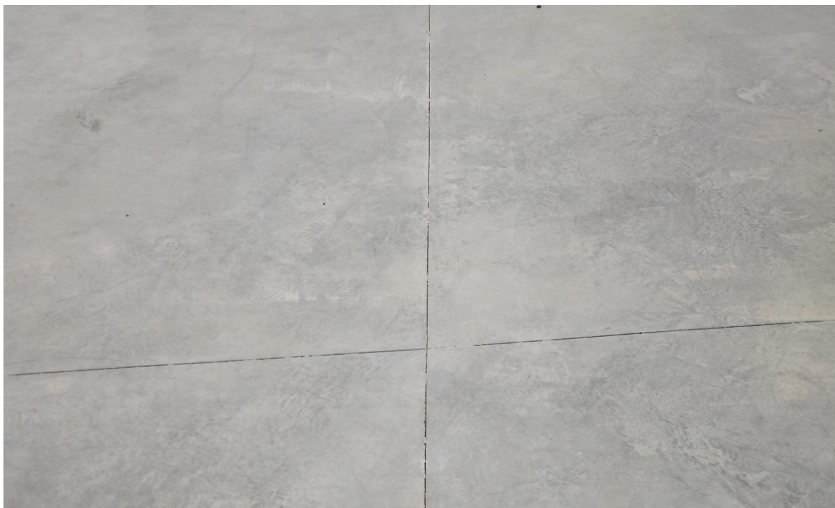
Figura 26 – Juntas sem o alinhamento correto na Obra C
