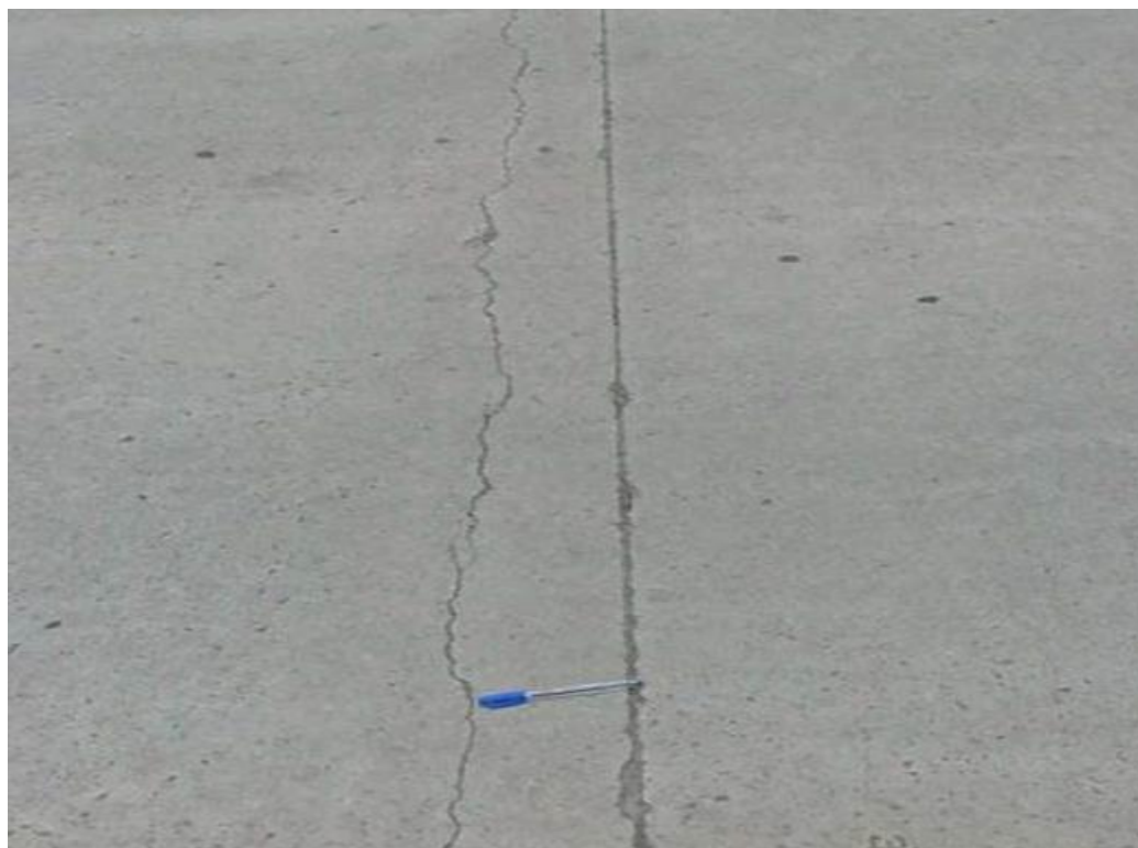
Figura 23 – Fissura paralela à junta de retração
