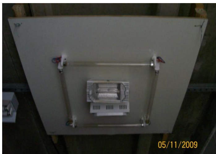
Figura 5 – Sistema de iluminação desativado
