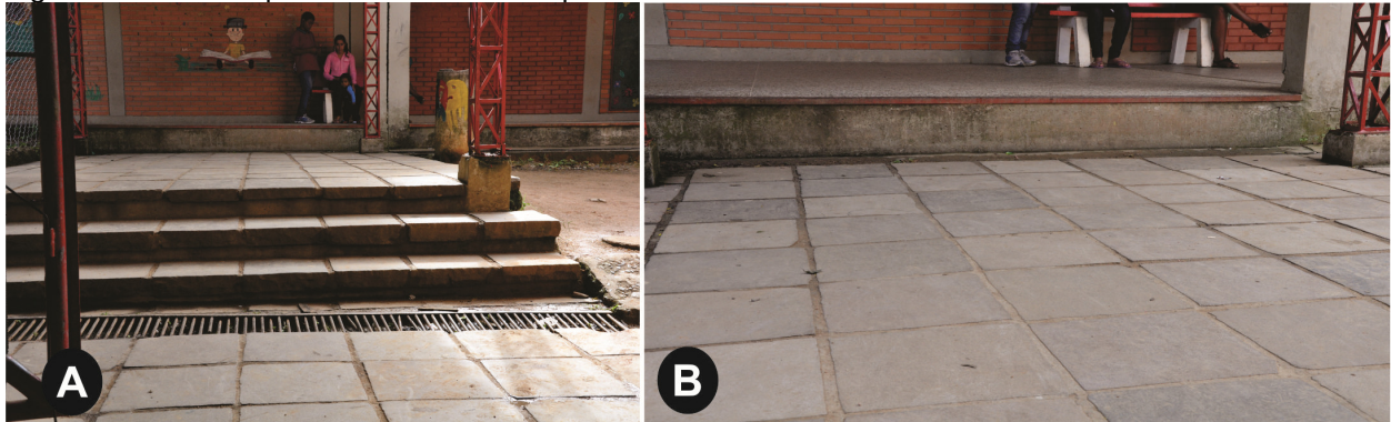
(A) Escadas sem a construção de rampa paralela. (B) Desníveis superiores a 15 cm
