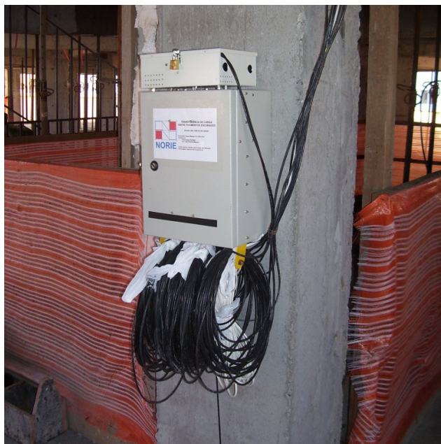
Figura 43: central de aquisição de dados em obra (fase 3)
