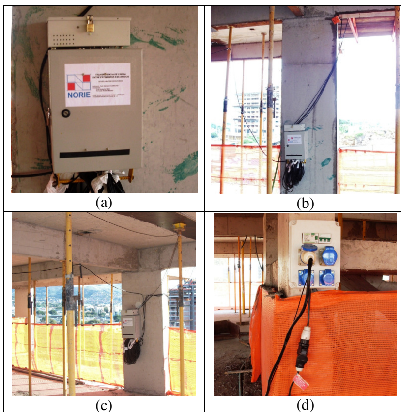
Figura 117: instalação da central de aquisição de dados. (a) vista frontal da central de aquisição de dados, (b) primeira instalação no pavimento imediatamente abaixo do primeiro pavimento instrumentado (térreo), (c) segunda instalação no quinto pavimento, (d) centro de distribuição elétrica, com cabo e tomada exclusiva, no sexto pavimento.
