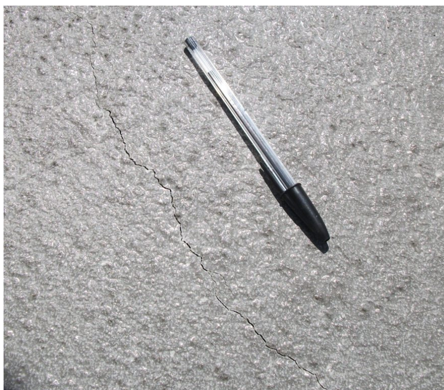
Figura 169: fissuração em uma laje reescorada com um dia de idade
