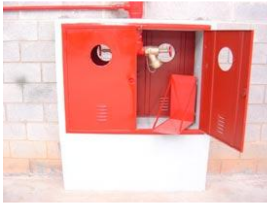
Figura 6.12 – Tomada de Incêndio Dupla
