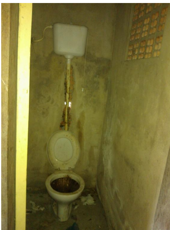
Figura 8– Sanitário obra 4 – vaso sanitário
